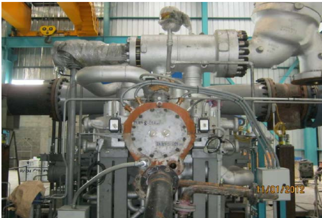
Extremo de la turbina
