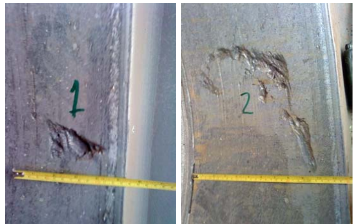
Detalle de los daños en la zona afectada
