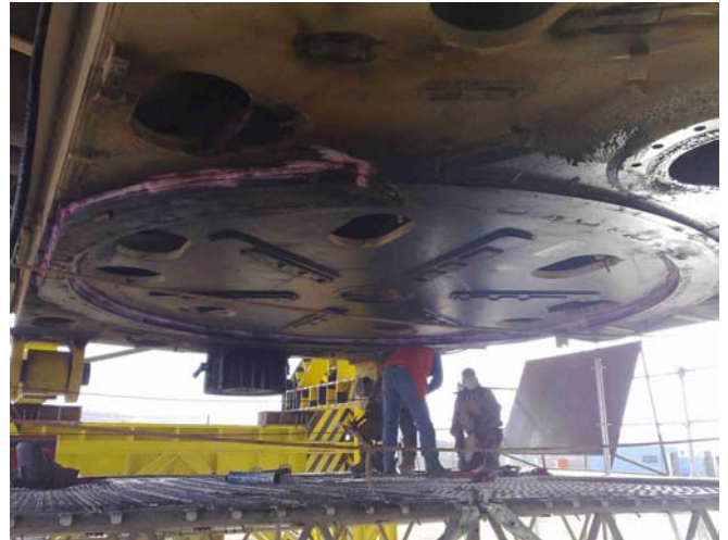
Fuente: 11122007027.JPG Parte inferior del revolving frame, con la zona afectada
