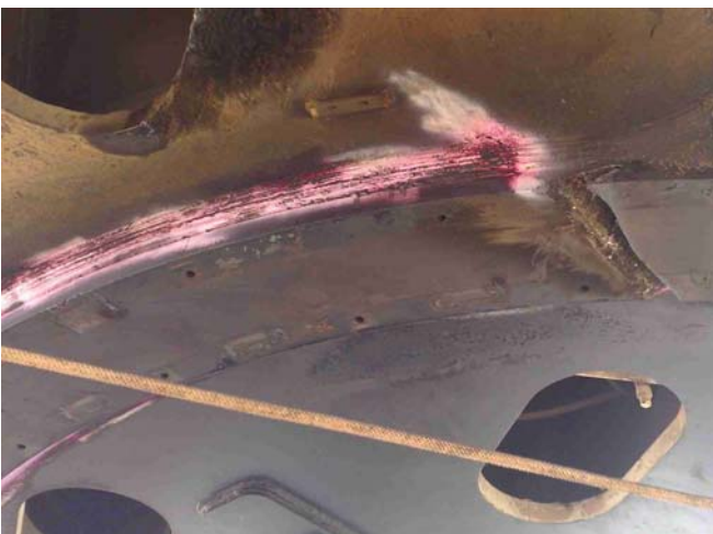
Fuente: 11122007030.JPG Zona afectada (sin soldar, con prueba tinte penetrante)
