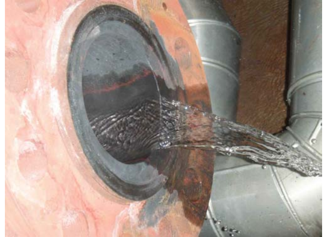
Fuente: PC140906.JPG Fuga que presentaba la válvula
